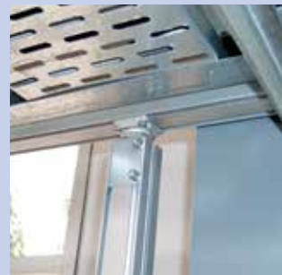
Rohrabgang mit Auslassplatte gelöst
